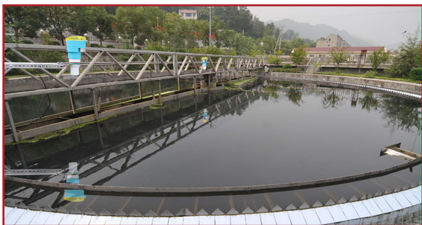
污水处理池工况
